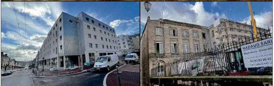
CHANTIERS. Les résidences seniors et étudiante du Puy Las Rodas (en haut), l'Espace Révolution et Le Présidial (en bas). PHOTOS F.J.
